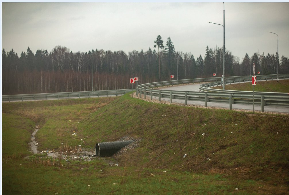
Figura 6-4: El agua de este camino pavimentado se drena en un área con césped.
